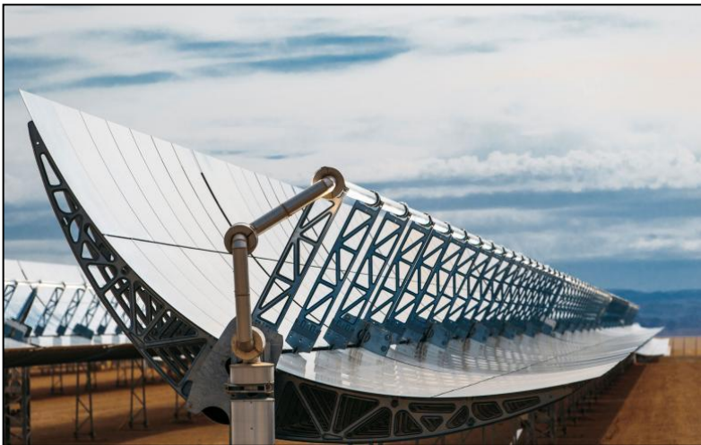
Figura N° 2.2 Planta solar Nor Ouarzazate I tipo colectores cilindro parabólicos
