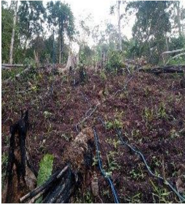
Imagen 9. Instalación de riego
