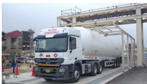
Figura 4.7 Cargadero de Camiones de GNL en PLNG
