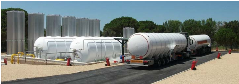
Figura 4.8 Tanque Criogénico GNL
