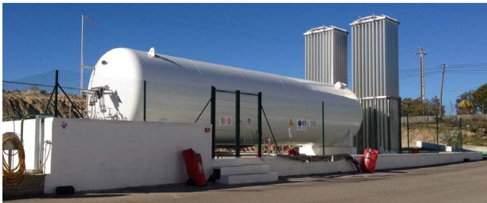
Figura 4.9 Tanque de Almacenamiento Horizontal (GNL)
